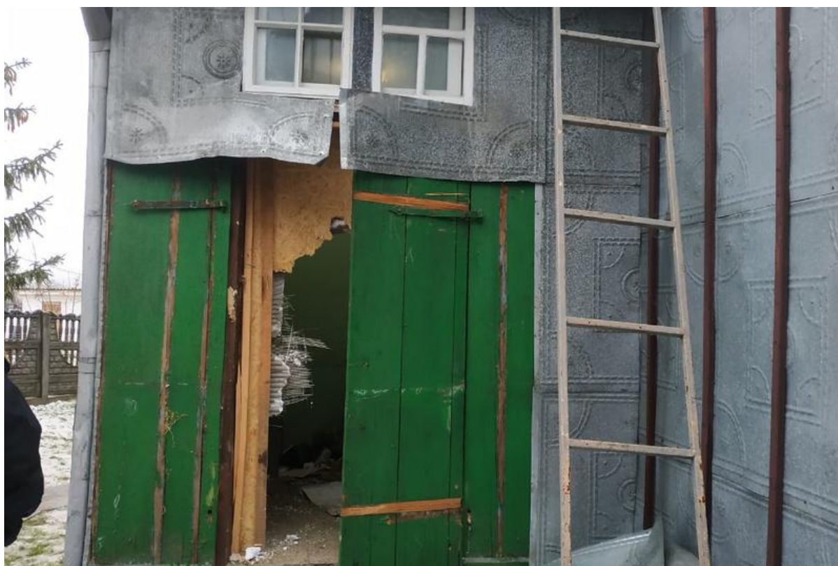
le porte della chiesa distrutte dai predoni con una mazza. Foto: eparchia di Chernovtsy-Buckovina della Chiesa ortodossa ucraina
