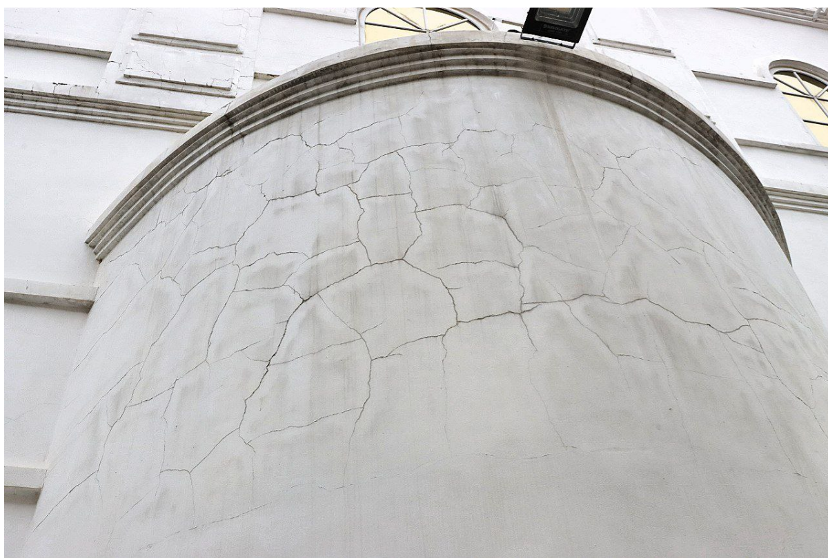
alcuni degli ingenti danni alla chiesa di San Giorgio
